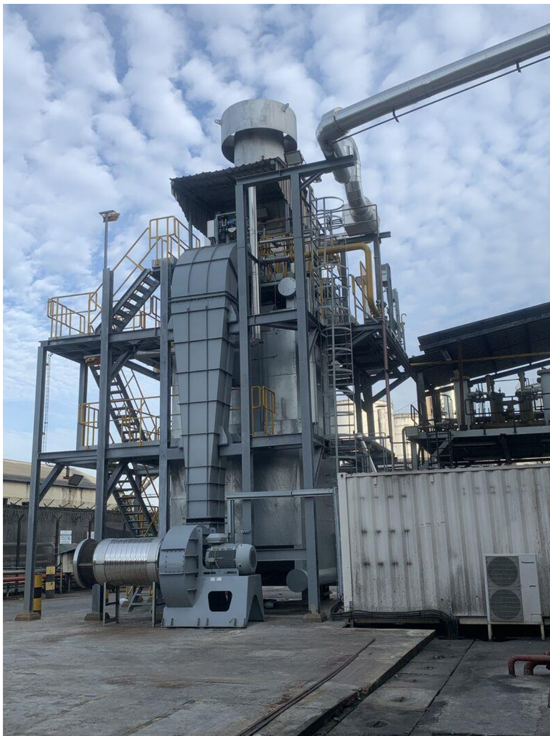
Рисунок 2.5 – Общий вид водонагревательной установки
